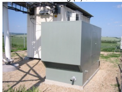
Telenor Mezőkövesd 60 kVA vandálbiztos kivitel / vandalproof execution
