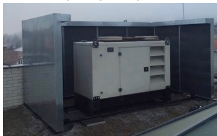
Hulladékgazdálkodás 60kVA zajvédő fallal
