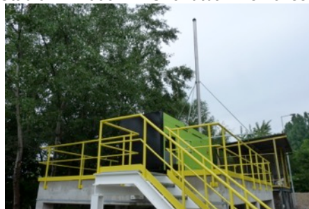
MOL Korneuburg (A) 510 kVA
