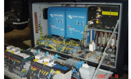
MAV Nostalgie / MAV Nostalgie Fischer Panda 30 kVA szupercsendes áramfejlesztő a kocsik alatt / Supersilent Fischer Panda set under the coach Victron Energy töltő-inverterek és villa- mos berendezés / inverter-chargers and electric installation
